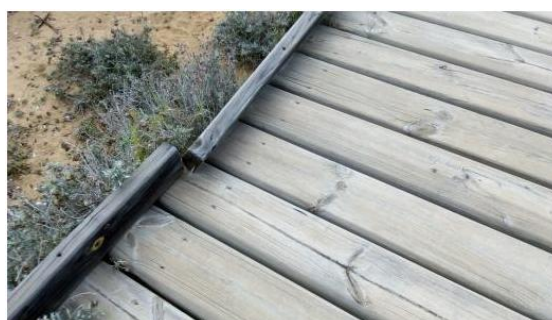
Foto 3 Imagen de una pasarela deteriorada que se pasó como incidencia a mantenimiento.
