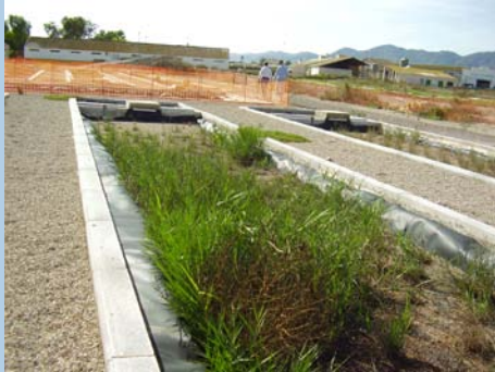
Detalle de una celda del humedal de flujo horizontal subsuperficial.
